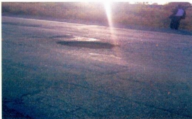
Figure 4: Linear longitudinal cracks
